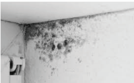
Tường nhà ẩm mốc
